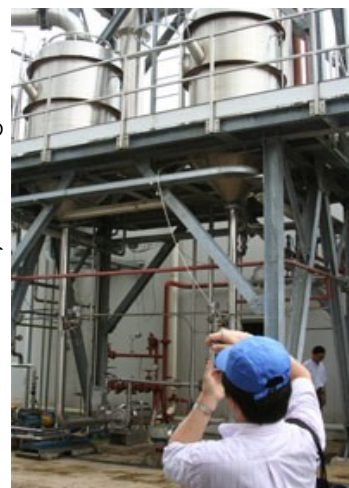
(写真)濃縮装置
